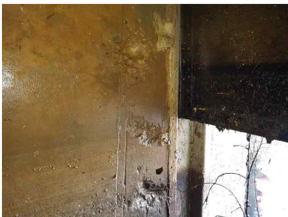
벽체 콘크리트 파손
