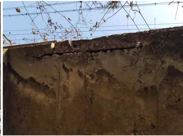
콘크리트 탈락, 철근노출
